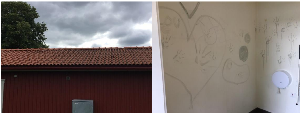
Några trasiga tegelpannor samt klotter i wc.
