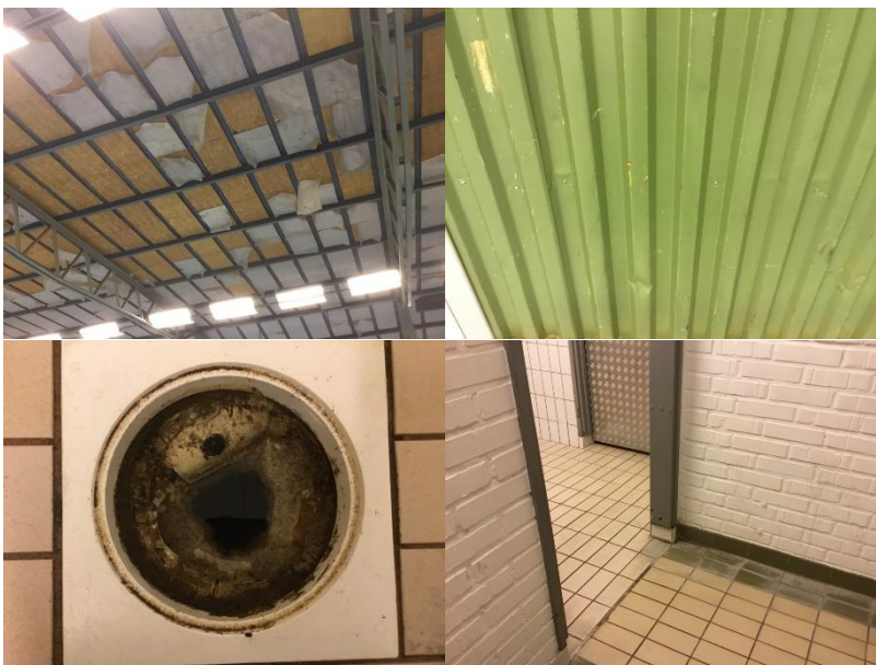
Delar av innertak og vegg i sporthallen samt golvbrunn i dusch og ytskikt omkl.
